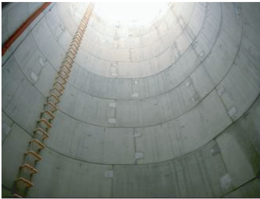
写真2 コンクリート製 Photo 2 Concrete urban-ring
